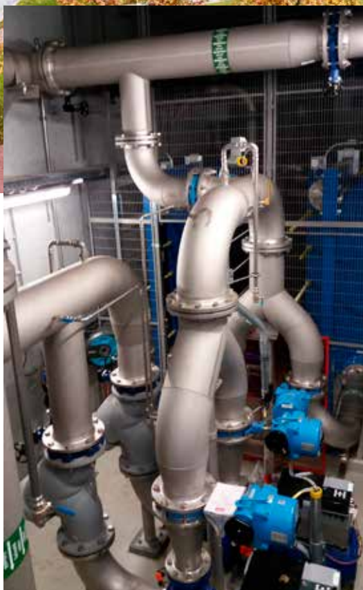
Op de WKO-installatie van Sanquin is 10.000 m 2 aan vloeroppervlak aangesloten.
