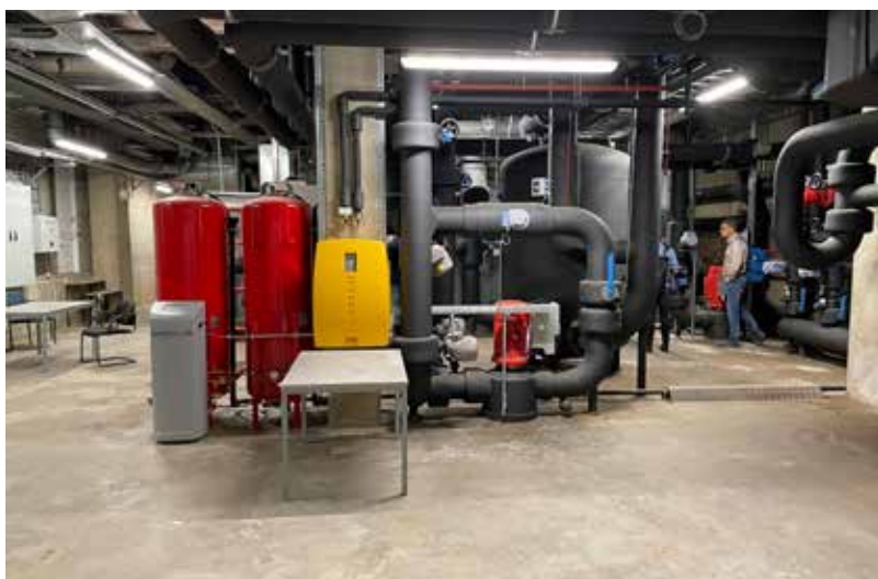
87 procent van de gebouwen op de Radboud campus is direct of indirect gekoppeld aan het netwerk met WKO's.
